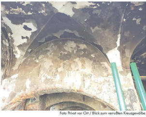
Foto Privat vor Ort / Blick zum verfallenen Kreuzgewölbe
